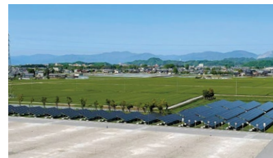
古河AS(株)本社工場:太陽光発電パネル設置 (2022年1月稼働開始)
