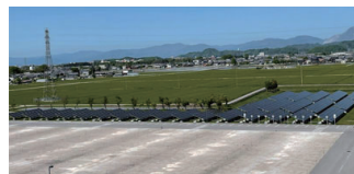
古河AS(株)本社が設置した太陽光発電パネル (2022年1月稼働開始)
